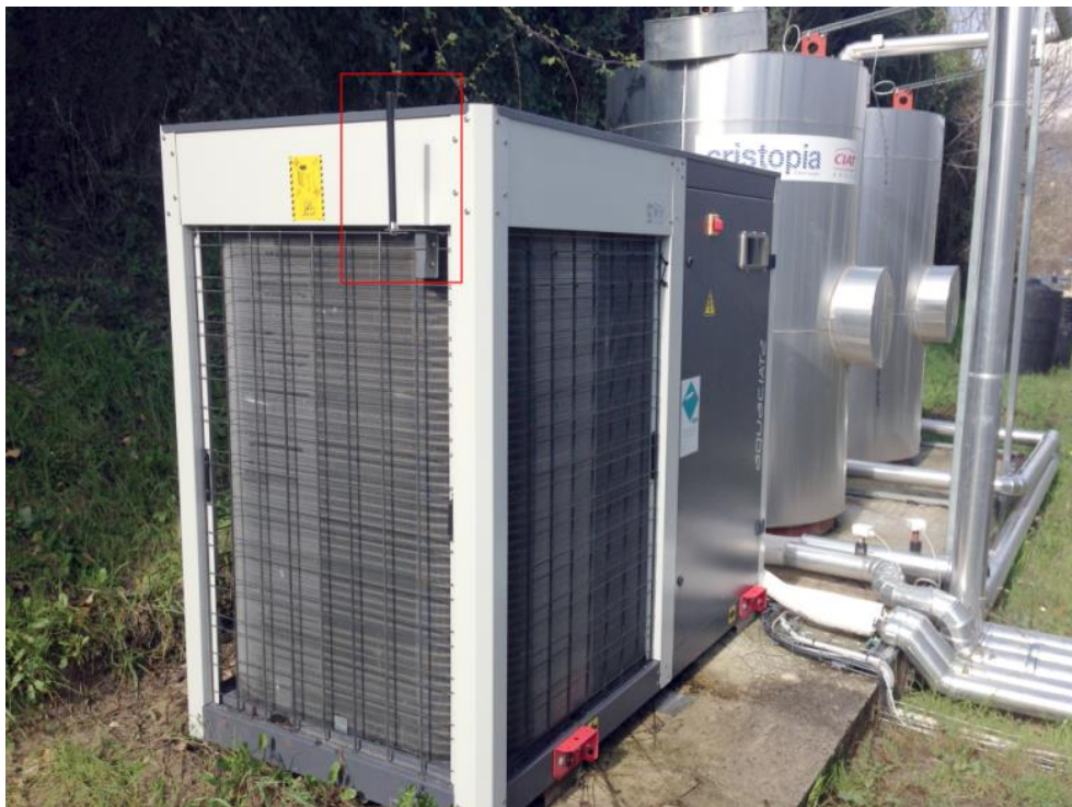
Exemple d'installation d'antenne sur une machine frigorifique
