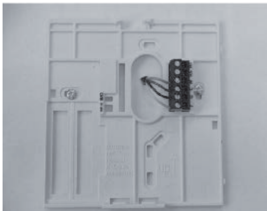
Fig. 2 - Connessioni cavi alla morsetteria
